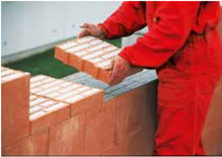
1 Versetzen des geschnittenen Ausgleichsziegels z. B. im Bereich einer Fensterbrüstung vermeidet Wärmebrücken.
