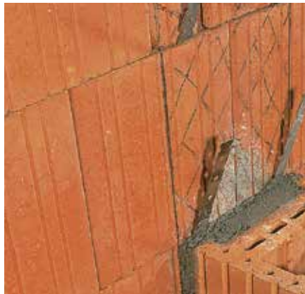
Wandanschluss: Stumpfstoß mit Flachstahlankern und satt vermörtelter Stoßfuge oder noch besser: Schlitzeinbindung in die Außenwand
