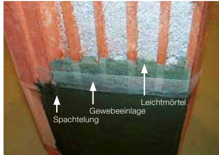
2 Verschließen einer offenen Schnittfläche, z. B. schräge Fensterlaibung (Leichtmörtel, Gewebeeinlage und Spachtelung bauseits).
