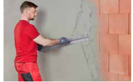
3 Nivelliermörtel Poroton Base eben verziehen (für die Arbeitsschritte 1 bis 3 die Hinweise auf Seite 181 beachten).
