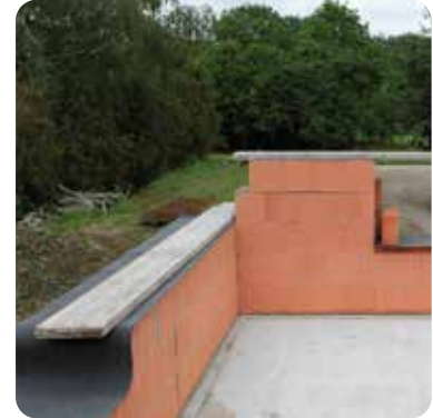
Fensterbrüstungen und Mauerkronen sind während der Bauphase gegen eindringendes Tagwasser (Regen und Schnee) zu schützen.
